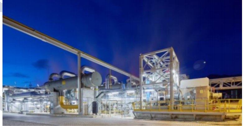
Şekil 3: Kızıldere II Jeotermal Elektrik Santrali [5]
